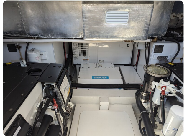
Bluegame 42 Onan generator
